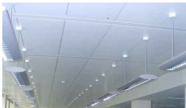
Topně-chladicí kazety Spektra vkládané do bandrasterového podhledu administrativní budovy.
