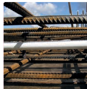
Trubky Pe-PEX jsou integrovány do konstrukce budovy
